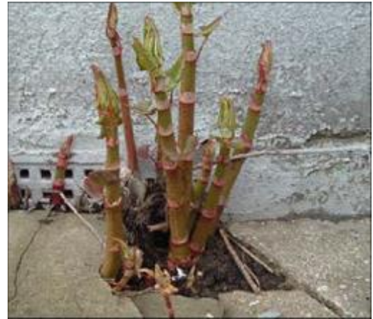
Muren, asfalt, funderingen en stoepen: de plant dringt er dwars doorheen.
